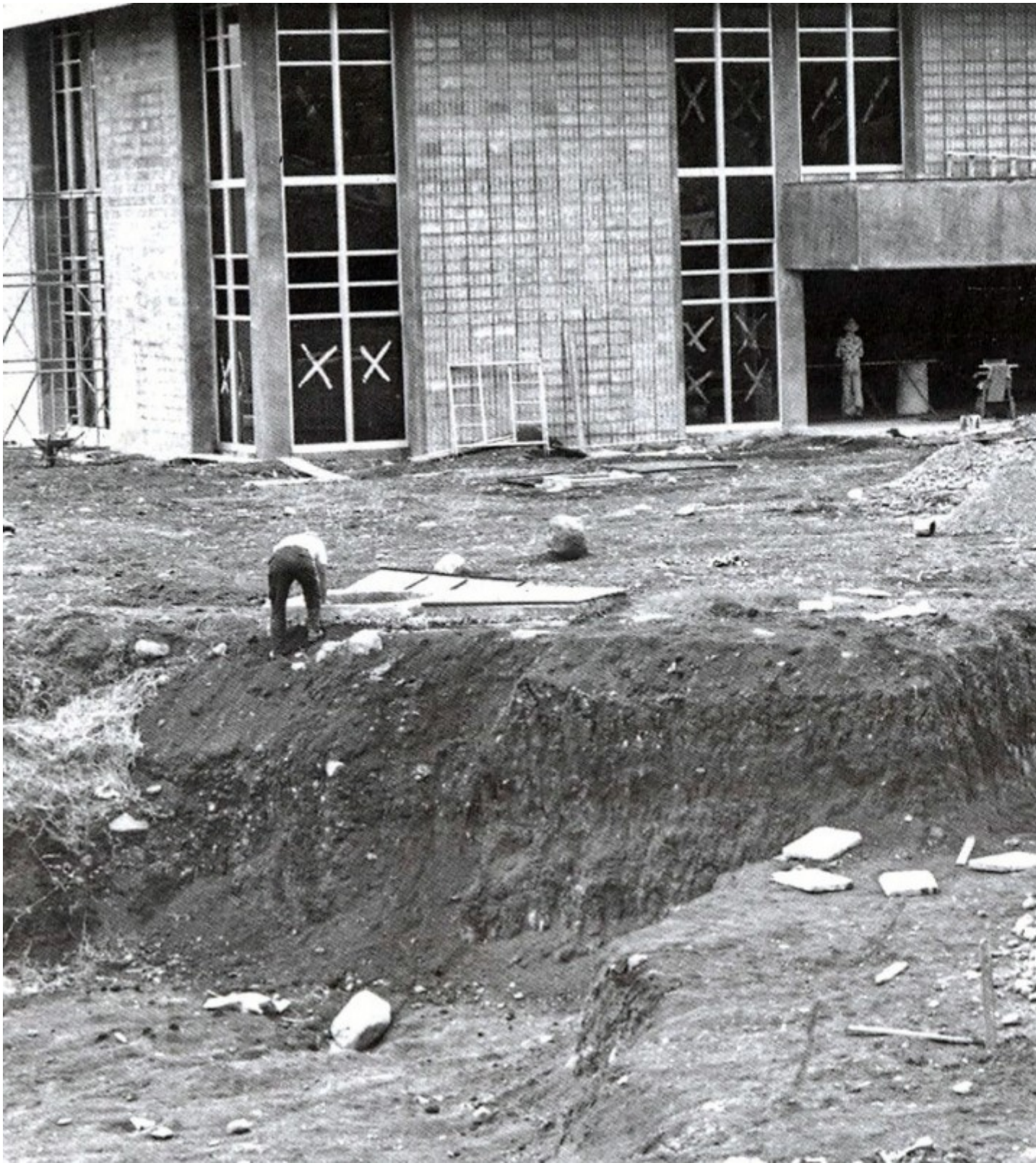
Construcción del actual edificio de la Biblioteca del TEC. Fotografía Archivo TEC.
